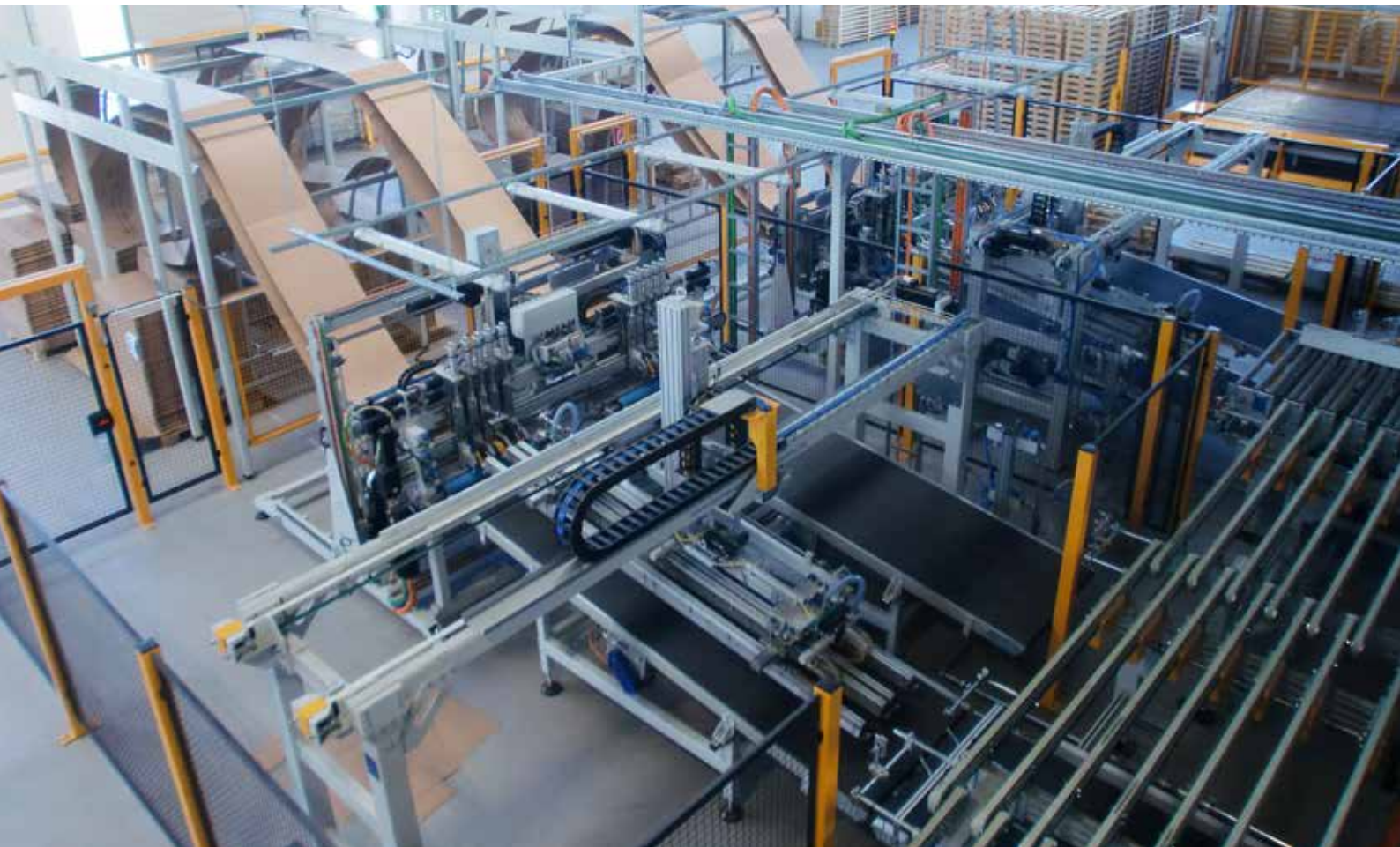
Beispiel einer vollautomatischen Verpackungsanlage mit Kartonage in Losgröße 1 als Kantenschutz
